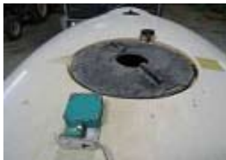
Figure 4: Mesure de niveau cuve
